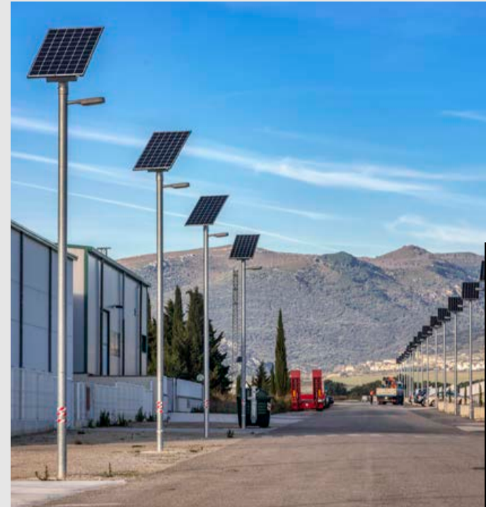
ALUMBRADO DE UN POLÍGONO INDUSTRIAL CON CONJUNTOS A MEDIDA. IMAGEN CORTESÍA DE ATP ILUMINACIÓN
