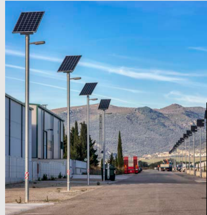
ALUMBRADO DE UN POLÍGONO INDUSTRIAL CON CONJUNTOS A MEDIDA. IMAGEN CORTESÍA DE ATP ILUMINACIÓN
