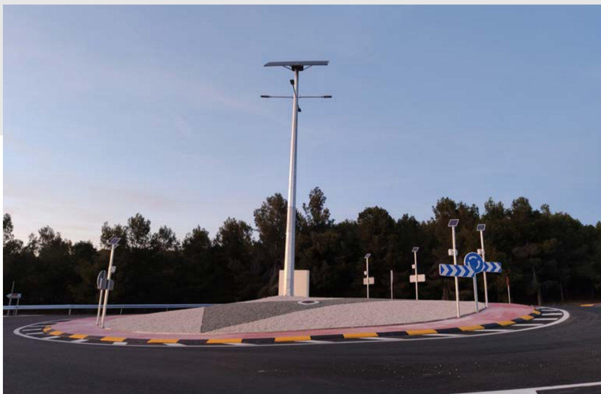
CONJUNTO PARA ILUMINACIÓN DE UNA ROTONDA. FOTO CORTESÍA DE SÖLVER
